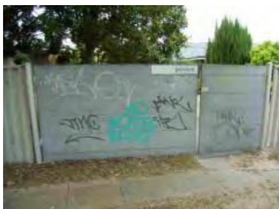
Figura 3 Assegure que o acesso a lotes fechados não estejam voltados para vielas ou áreas de pouca vigilância.
