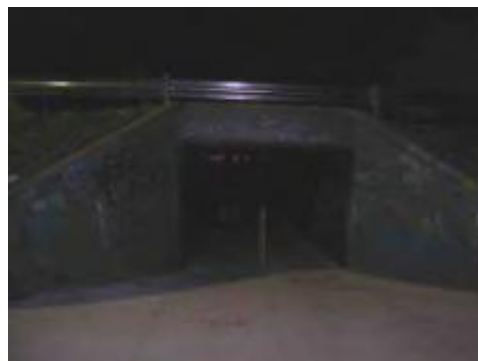
Figura 39 Passagens subterrâneas sem iluminação aumentam a sensação de insegurança
