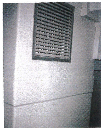
Grelha de insuflamento no interior de uma escada pressurizada
