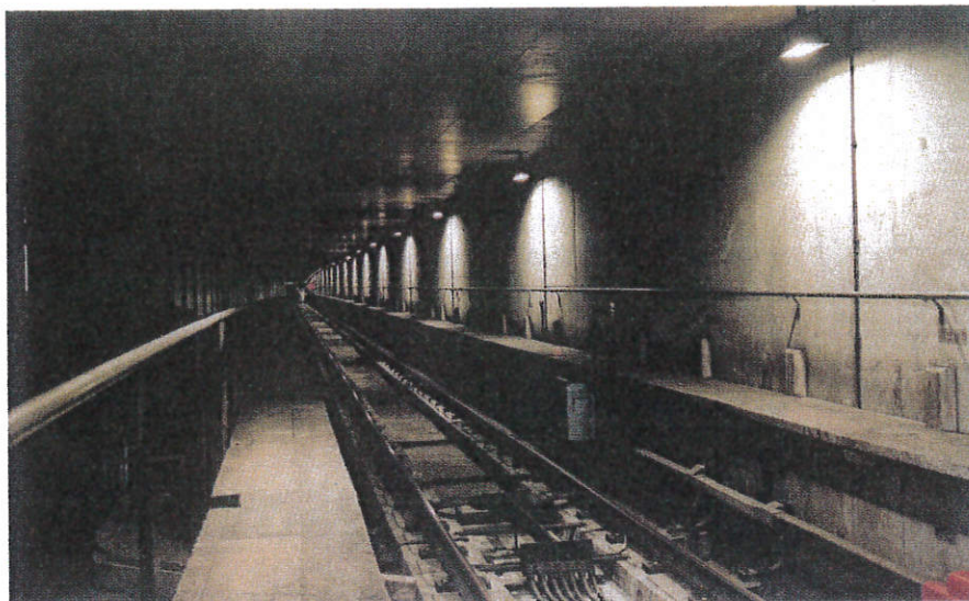
Túneis do metrô possuem passarelas e saídas de emergência entre as estações
